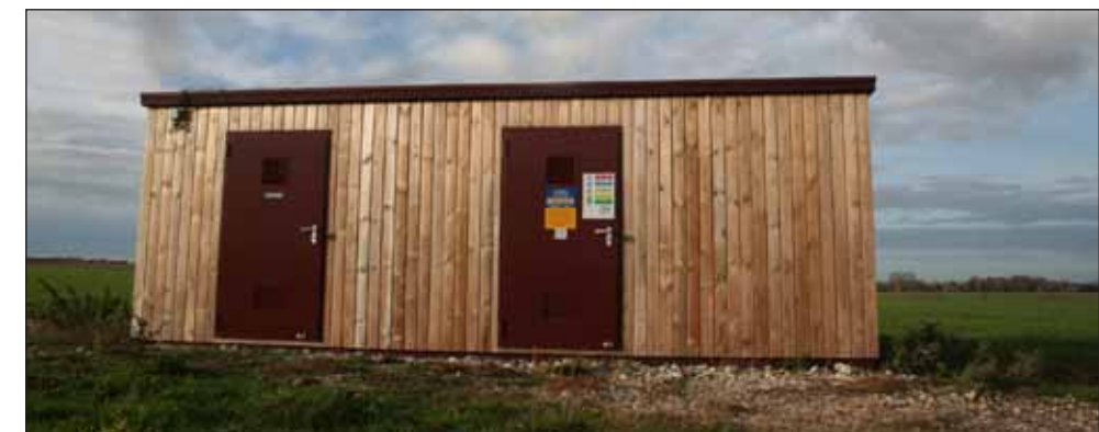
Exemple-type de poste de livraison
